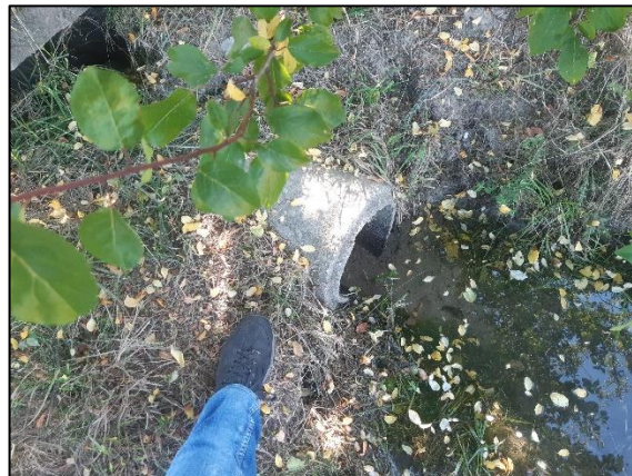
Obr. 8: Detail poničeného hospodářského přejezdu
