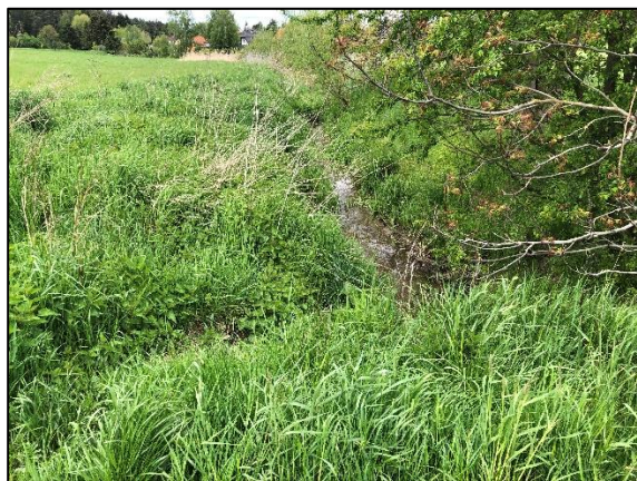
Obr. 5: Pohled na zarostlou část koryta Rokytky za propustkem
